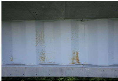
写真-2 波形鋼板ウェブ腐食状況
