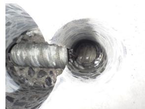
図-5 PC 鋼材破断箇所
