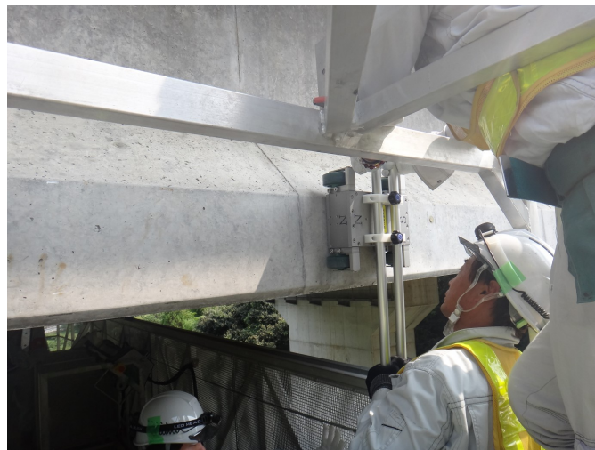
写真-6 点検車走行による下フランジ部側面の着磁状況
