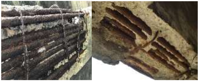
図 5 桁下の鉄筋露出 (左 G4 右 G1)
