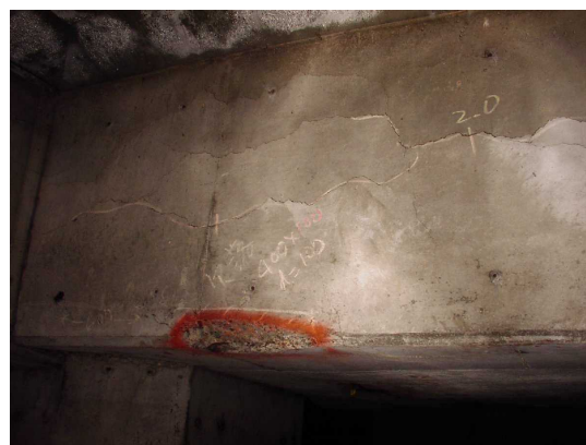
写真-1 ASR によるひび割れ（梁）
