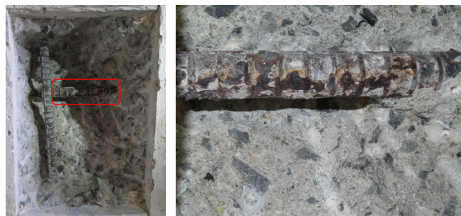
(a) 掘削範囲全体 (b) 水平鉄筋表面の拡大 図-4 防食範囲における鉄筋表面の状況（掘削 1）
