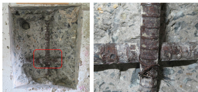
(a) 掘削範囲全体 (b) 鉄筋表面の拡大 図-5 防食範囲における鉄筋表面の状況（掘削 2）
