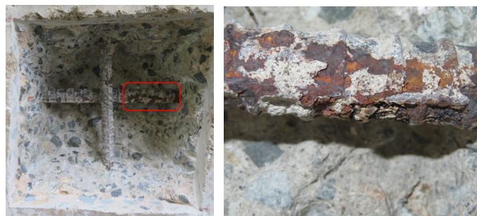
(a) 掘削範囲全体 (b) 水平鉄筋腐食部の拡大 図-6 防食範囲外における鉄筋表面の状況（掘削 4）
