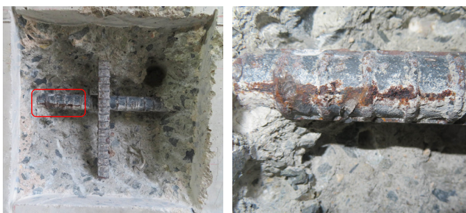
(a) 掘削範囲全体 (b) 水平鉄筋腐食部の拡大 図-7 防食範囲外における鉄筋表面の状況（掘削 5）
