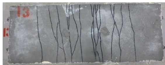
図-4 暴露前のひび割れ状況 (飛沫帯：ひび割れ導入)
