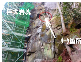
写真-4. 周辺亀裂から生じたリーク状況
