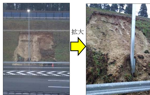
写真-1 のり面崩壊状況
