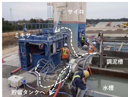
図5 現場導入プラント
