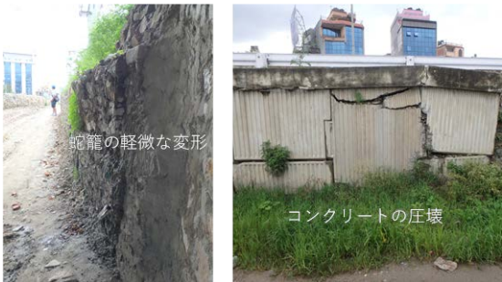
(a) 蛇籠構造 (b) コンクリート製擁壁 写真-1 コンクリート・蛇籠構造物の被災事例
