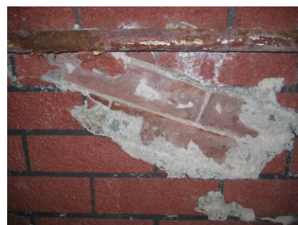
図 2 トンネル内部の劣化状況
