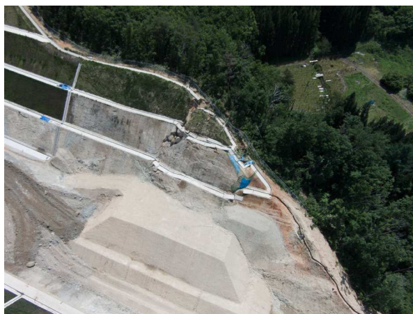
写真-1 のり面変状範囲
