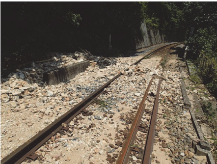
図 1 鉄道における小規模な土砂流入災害の事例
