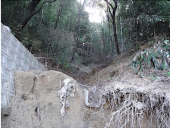
図 1-1 西日本豪雨における斜面崩壊事例
