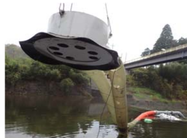
写真-1 管径 300mm 潜行吸引式排砂管
