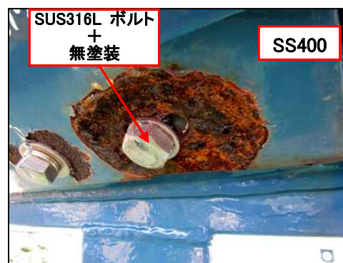
写真-4 異種金属腐食事例
