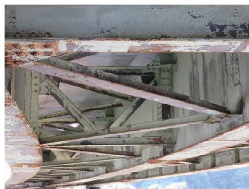
写真-1 塗膜の劣化事例
