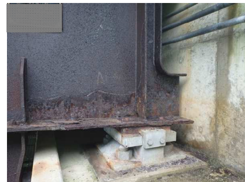
写真-2 耐候性鋼板の腐食事例
