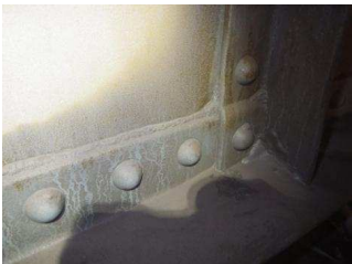
写真-5 研削材の固着
