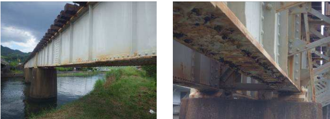
写真-2 塗膜の劣化状況
