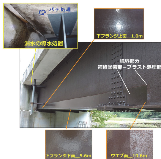
図3 約9年(105ヶ月)経過した部分補修塗装部の外観
