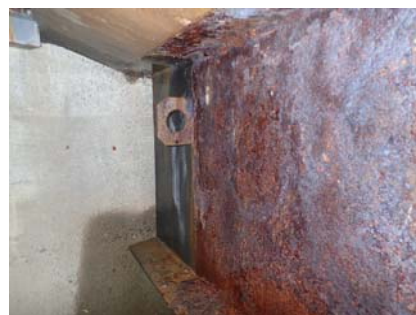
写真1 異常さびの発生状況
