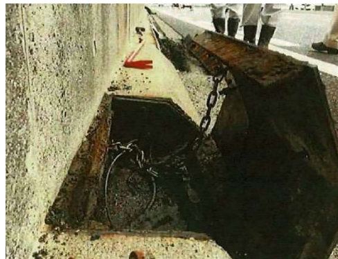
写真-1 鋼製排水溝の劣化
