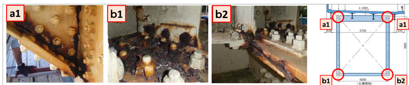
図-2 鋼トラス部材の腐食状況
