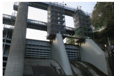
図-1 補強されたダムピア
