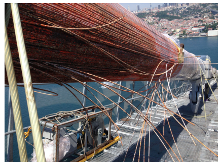
図1 素線損傷状況
