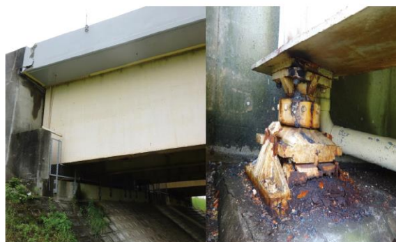
写真-1 緑川橋の支承の損傷状況
