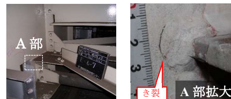
写真-1 ガセットの止端部のき裂
