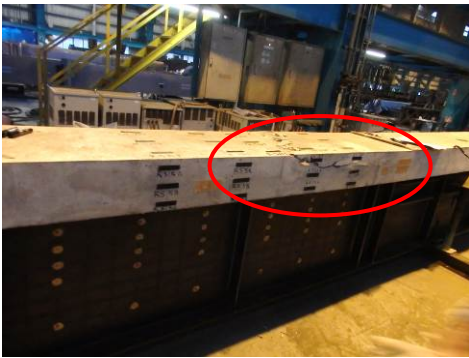
図 6 破壊状況 (E)
