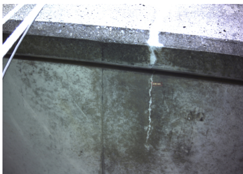
写真1 張出床版のひび割れ
