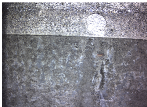
写真2 地覆のひび割れ
