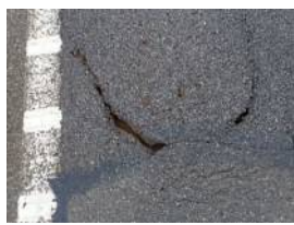
写真-1 路面損傷状況
