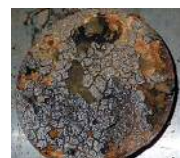
2)Uリブ内腐食
