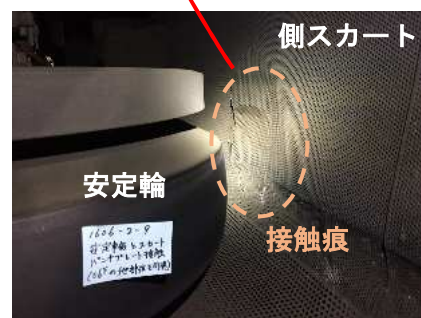
写真2 側スカートと安定輪の接触痕
