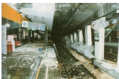
写真1 神戸高速鉄道大開駅中柱被災状況
