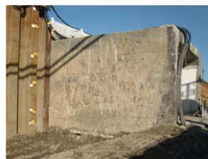
写真6 ボックス残置部
