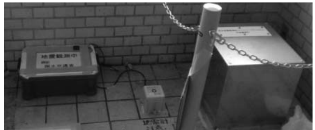
図-2 国総研臨時地震計(既設震度計近傍)
