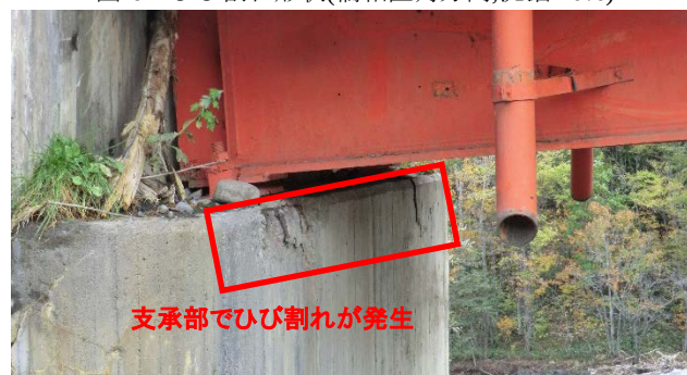
図-7 橋台被災状況(左岸から撮影)
