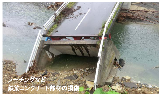
図-1 橋台被災状況(右岸から撮影)
