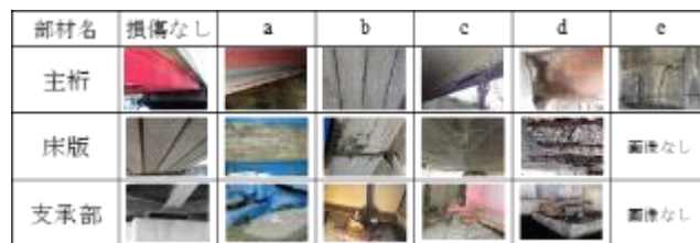
図 1 損傷写真の例
