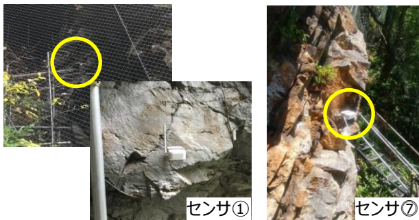
図-3 傾斜センサ設置状況
