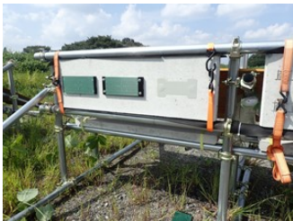
図-8 ベースプレートの脱落
