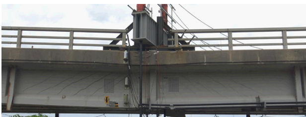
写真-2 破壊状況
