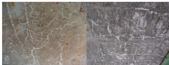
写真-1 床版下面の遊離石灰の発生状況 面積率
