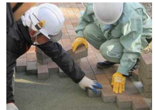
図-5 インターロッキング舗装
