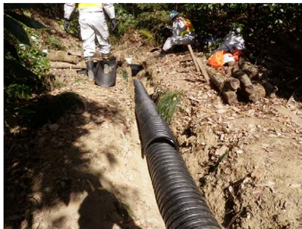
図2 水路整備状況
