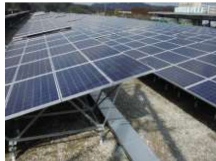
写真1 太陽光発電架台
