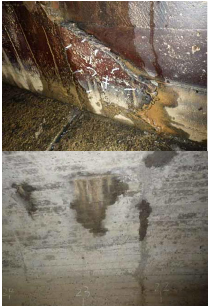
図-1 トンネル覆工劣化状態
