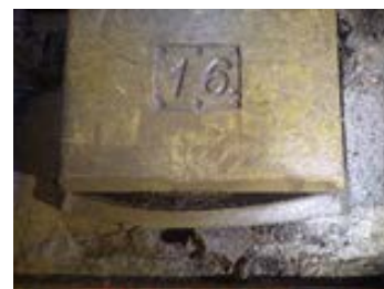
写真-2 弾性材の剥がれ
