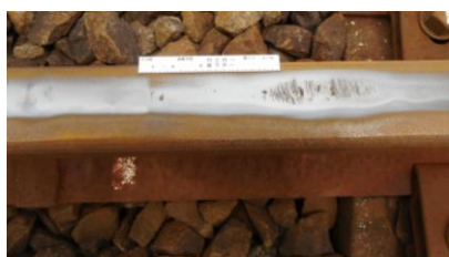
(a) 溶接部付近に発生 (12%)
