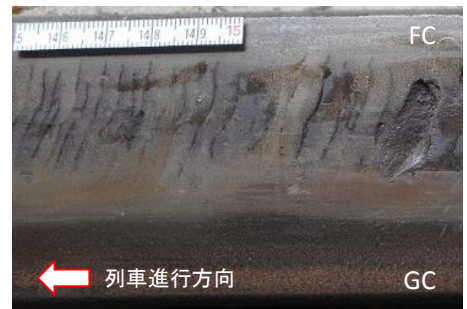
図 3 分析レールの外観
