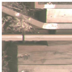
【図-1】継目部抽出漏れ例
