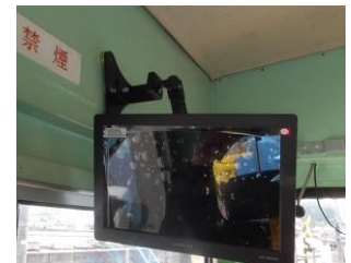
写真-3 モニター設置状況
