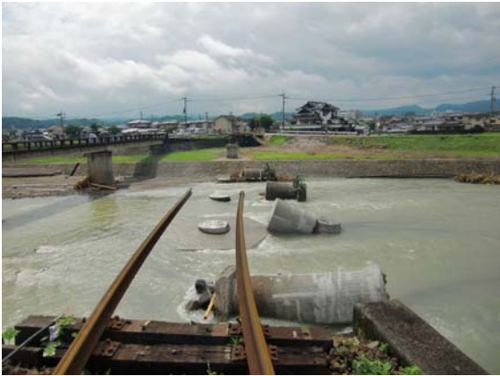
写真-1. 花月川橋りょう被災状況
