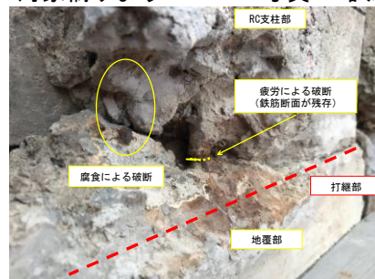
写真-5 打継部の変状
