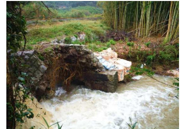
写真-5 大型土嚢流出
