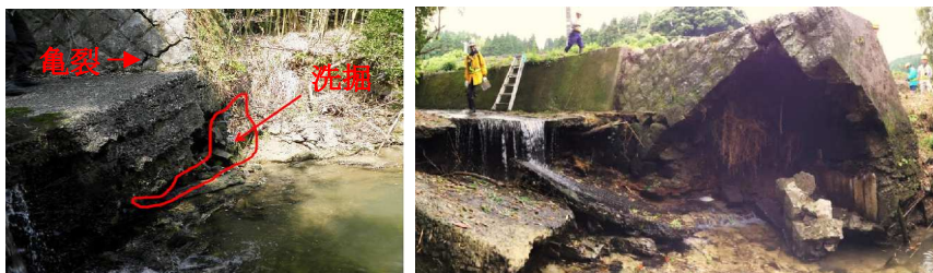
写真-1 変状写真(2016年)
